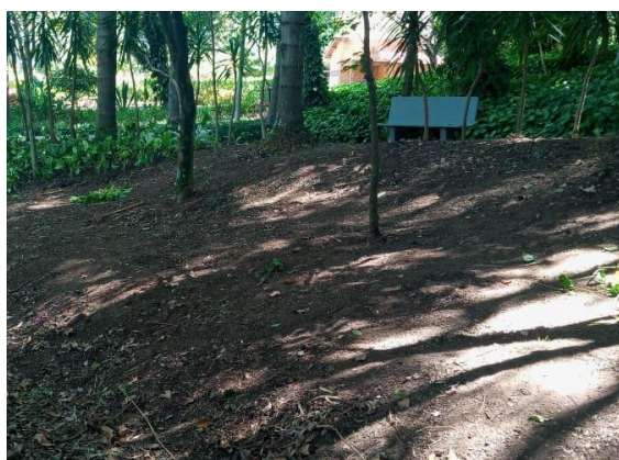
Figura 17: Área sem vegetação, com possível risco de erosão
